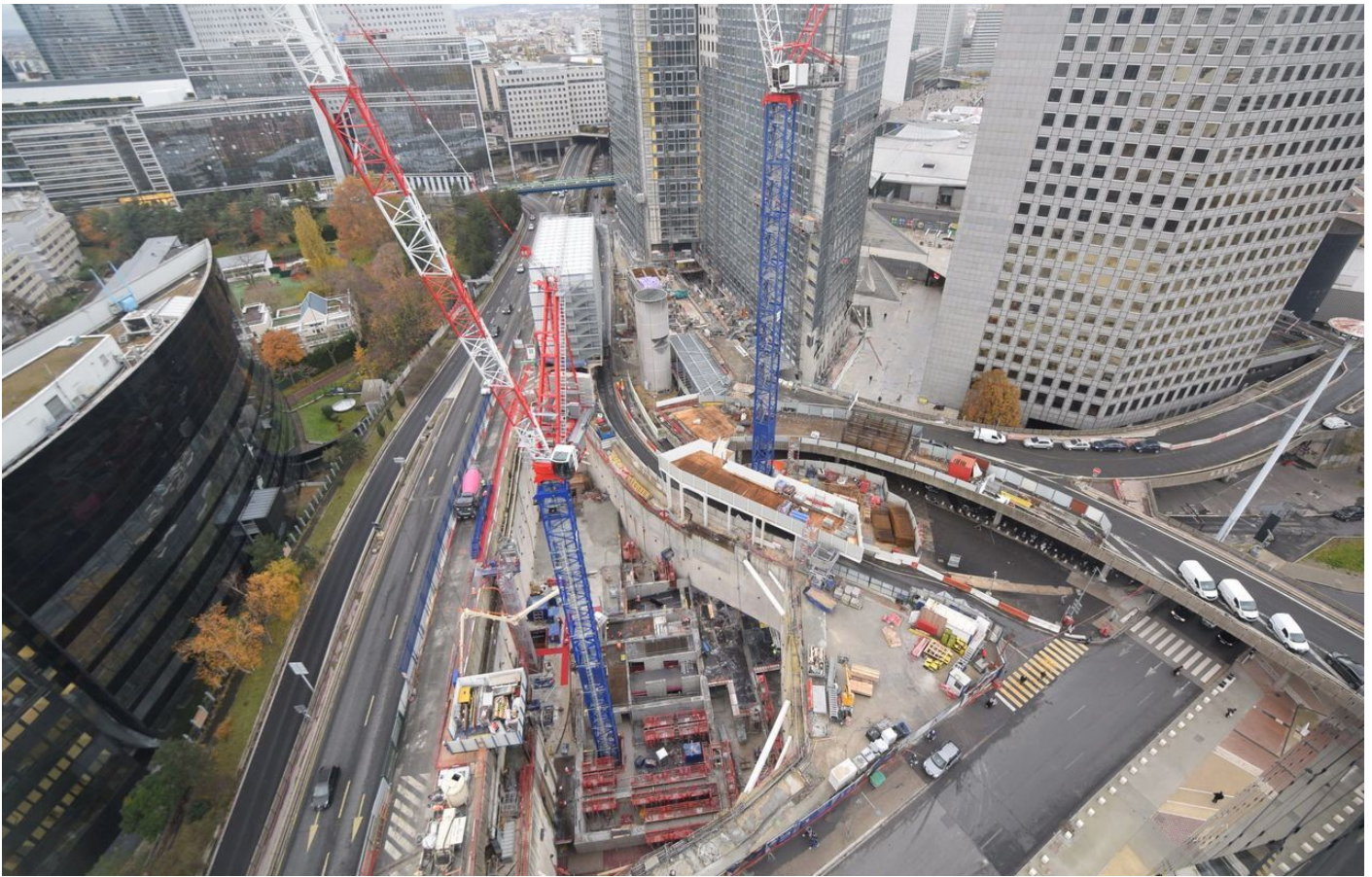
La Défense, novembre 2019. Chantier de la tour Hekla, lancé en juillet 2018, au centre du carrefour de la Rose de Cherbourg. DR.
